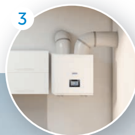
3 NANOCLIMA. Installazione per servizio di riscaldamento/raffrescamento.
